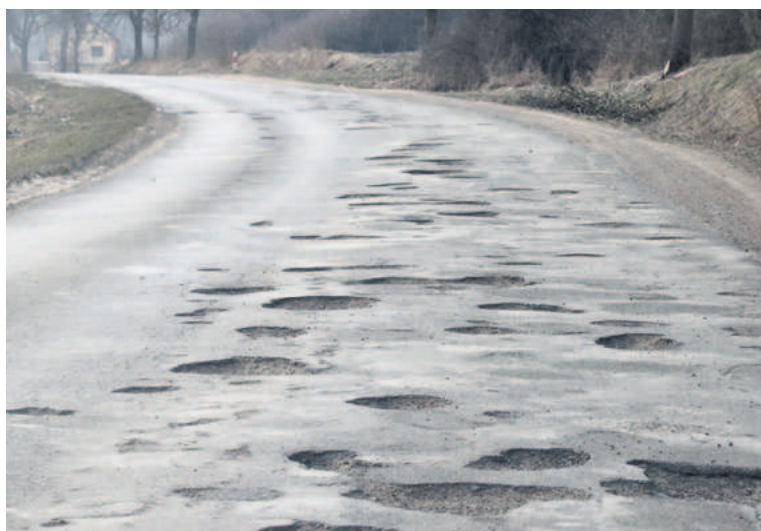
Część ubytków na ul. Toruńskiej załatano, jednak kilkaset metrów za rogatkami miasta droga przypomina już ser szwajcarski
