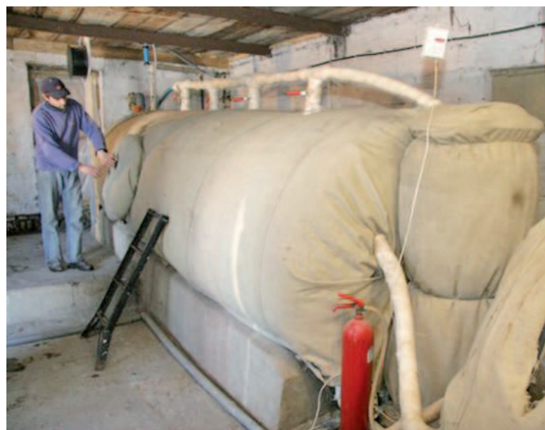
Zdjęcie biogazowni przydomowej w okolicach Zamościa
