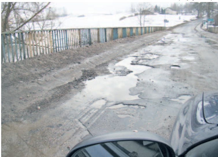
W opłakanym stanie znajduje się mostek na Drwęcy w Elgiszewie. Jego generalną naprawę utrudnia prawo. Most znajduje się w obszarze Natura 2000, przez co każda ingerencja człowieka wymaga wielu pozwoleń
