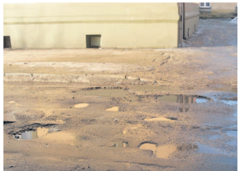
Stan nawierzchni ul. Katarzyńskiej w Golubiu-Dobrzyniu
