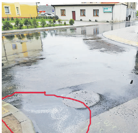
W wyniku remontu skrzyżowania ulicy Mazowieckiej i Polnej woda i tak gromadzi się na drodze
