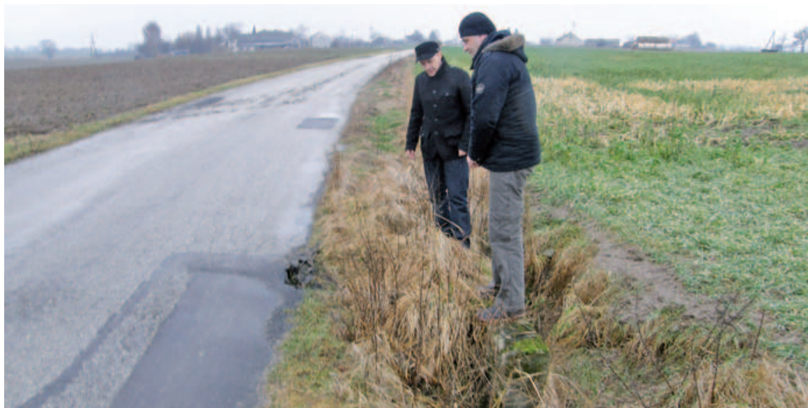
Jakubkowo – ten przepust trzeba udrożnić, a drogę naprawić
