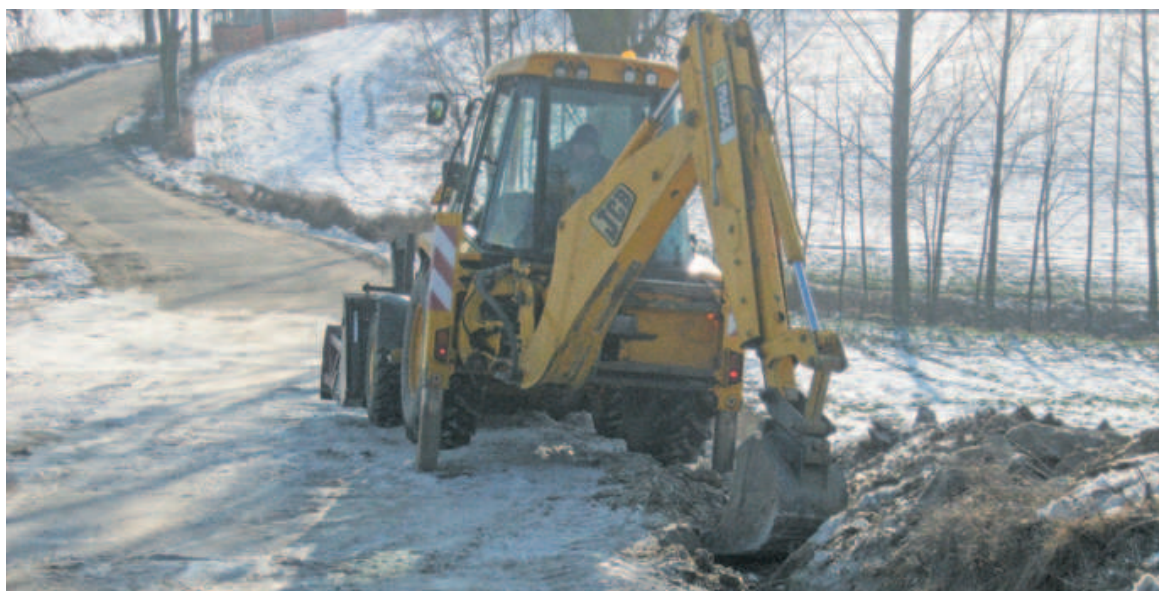
Odwodnienie na drodze powiatowej w Kamionce
