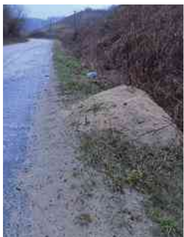
Materiał naprawczy drogi jeszcze leży na poboczu
