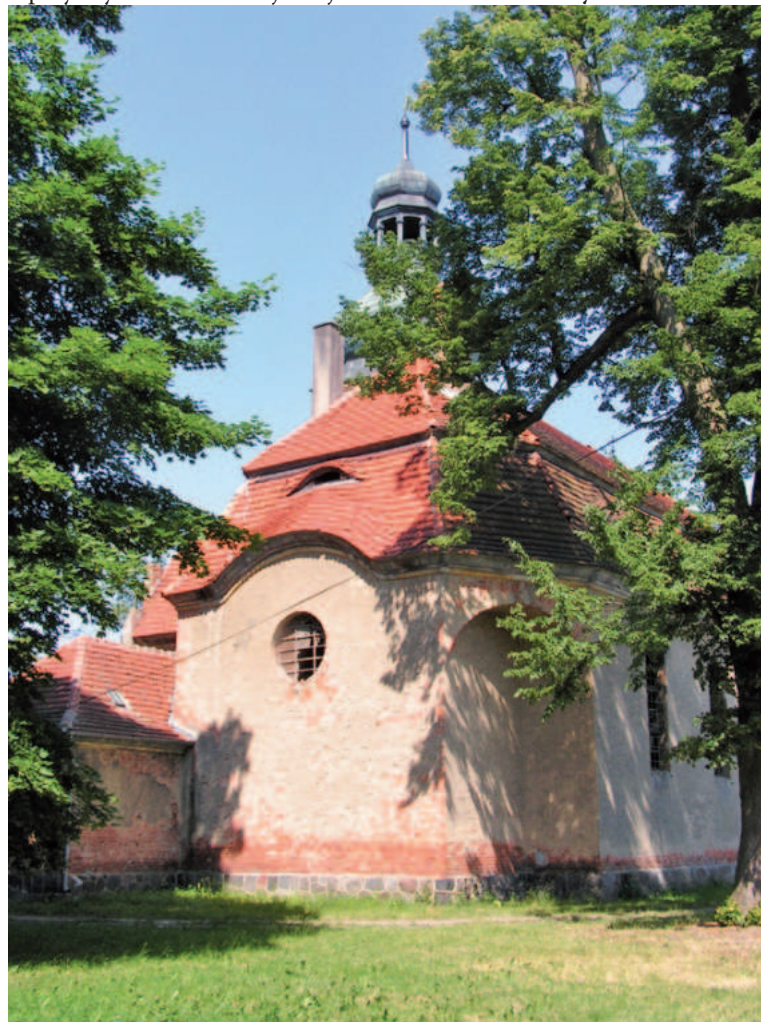
Natychmiastowego remontu wymaga dach zboru
