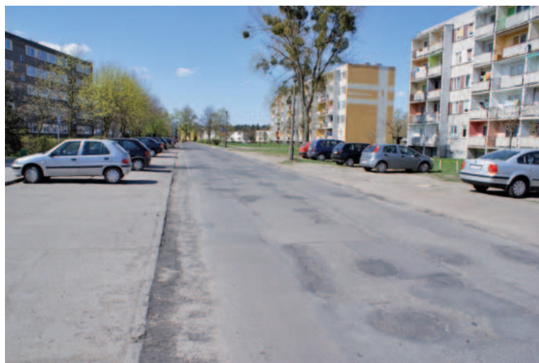
Ulica Mickiewicza wymaga remontu. Zostanie on przeprowadzony jeszcze w tym roku
