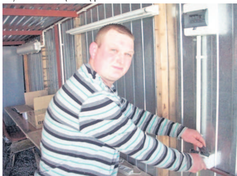
Grzegorz Lewandowski pokazuje sprawną instalację elektryczną, która teraz będzie zasilana z agregatu przekazanego hodowcom
